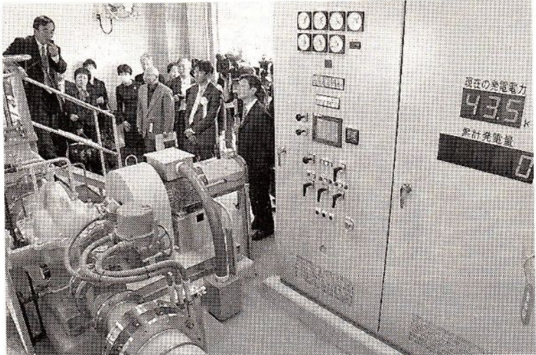
完成セレモニー後、小水力発電施設を見学する関係者ら＝生駒市山崎町
